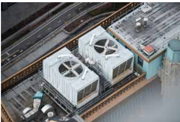
Sistema de climatización (HVAC)
